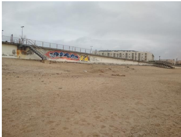
Fig.2 Diminuição do areal causa danos nas infraestruturas
